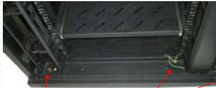
Κεντρικό σημείο γείωσης
